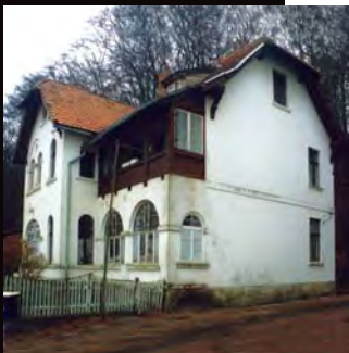
Zustand vor der Sanierung
