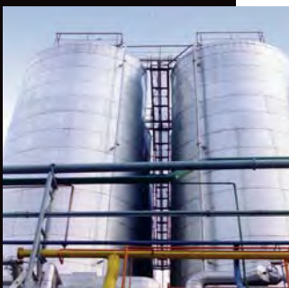
Blick auf die Stirnseite der Tankanlage
